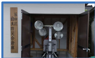
災害対応用の備品・設備等の整備
